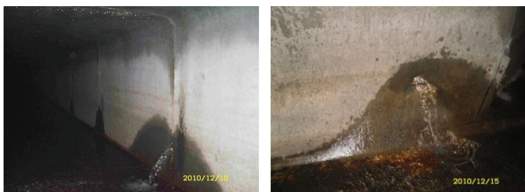
Figura 8.26: Infiltrazioni di acque di falda all'interno della rete di drenaggio CIPAF.
