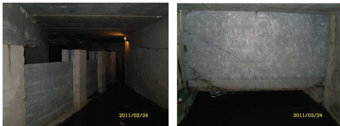
Figura 7.10: Sfiatore di piena, visto da valle, posizionato alla fine del canale di gronda per l'immissione delle acque di esubero nel collettore Est (foto a sinistra) - Paratoia di regolazione, vista da monte, localizzata immediatamente a monte dello sgrigliatore nel collettore Est (foto a destra).
