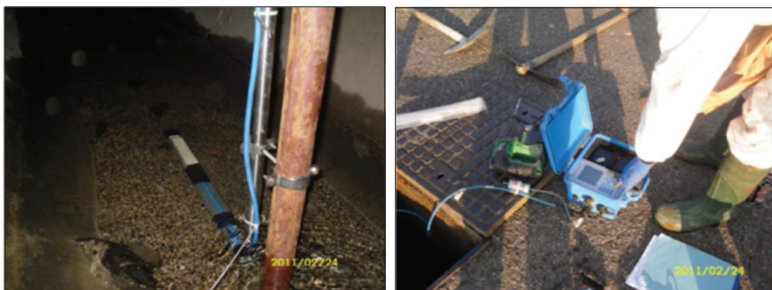
Figura 8.2: Fissaggio dello zoccolo di supporto al sensore di misura area-velocity nel fondo collettore (a sinistra). Programmazione data logger associato al sensore di misura (a destra).
