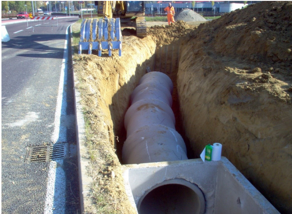
Fig. 3.3: Tubazione interrata segmenta in cemento con giunti a bicchiere per il trasporto di rifiuti liquidi.
