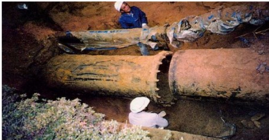
Fig. 3.4: Rottura per sfilamento del giunto flangiata in una condotta per acqua.
