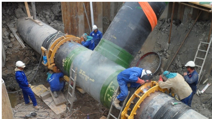
Fig. 3.1: Tubazione interrata continua in acciaio con giunti saldati per il trasporto di petrolio greggio.
