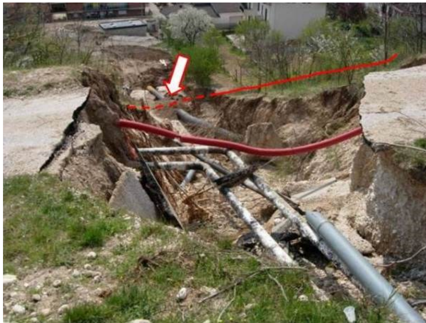
Fig. 5.6: Effetti della fagliazione superficiale sulla condotta interrata causata da una dislocazione verticale generata dalla faglia di Paganica. In rosso il tracciato della faglia mentre la freccia evidenzia la zona della rottura della condotta.
