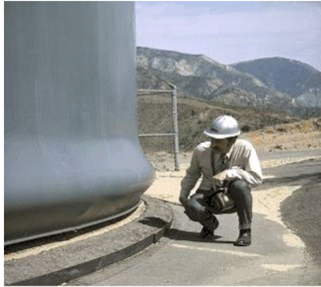
Fig. 3.7: Esempio tipico d'instabilità del mantello ( elephant foot buckling ).
