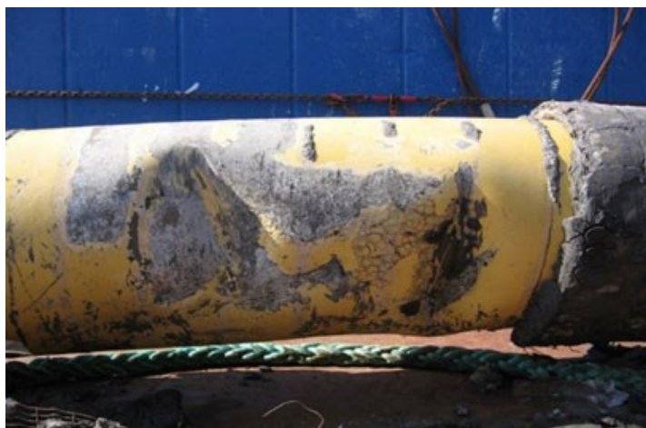
Fig. 3.2: Deformazione per instabilità ( buckling ) in una condotta continua d'acciaio.
