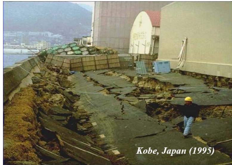
Fig. 5.13: Danneggiamenti alla banchina del porto di Kobe a seguito del terremoto avvenuti nel 1995.
