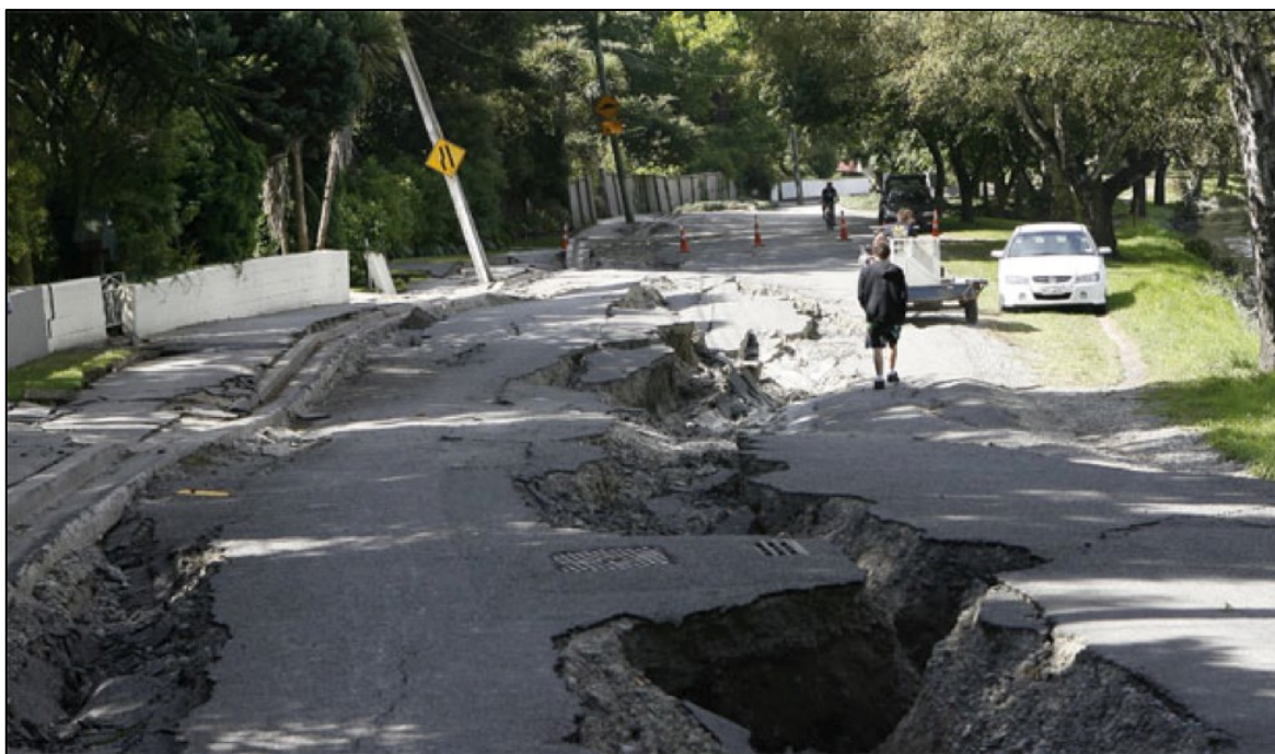
Fig. 5.19: Notevoli danneggiamenti a una strada di città dovuti a fenomeni di liquefazione che hanno indotto effetti di dislocazione laterale avvenuti a seguito del terremoto di Christchurch del 2011.
