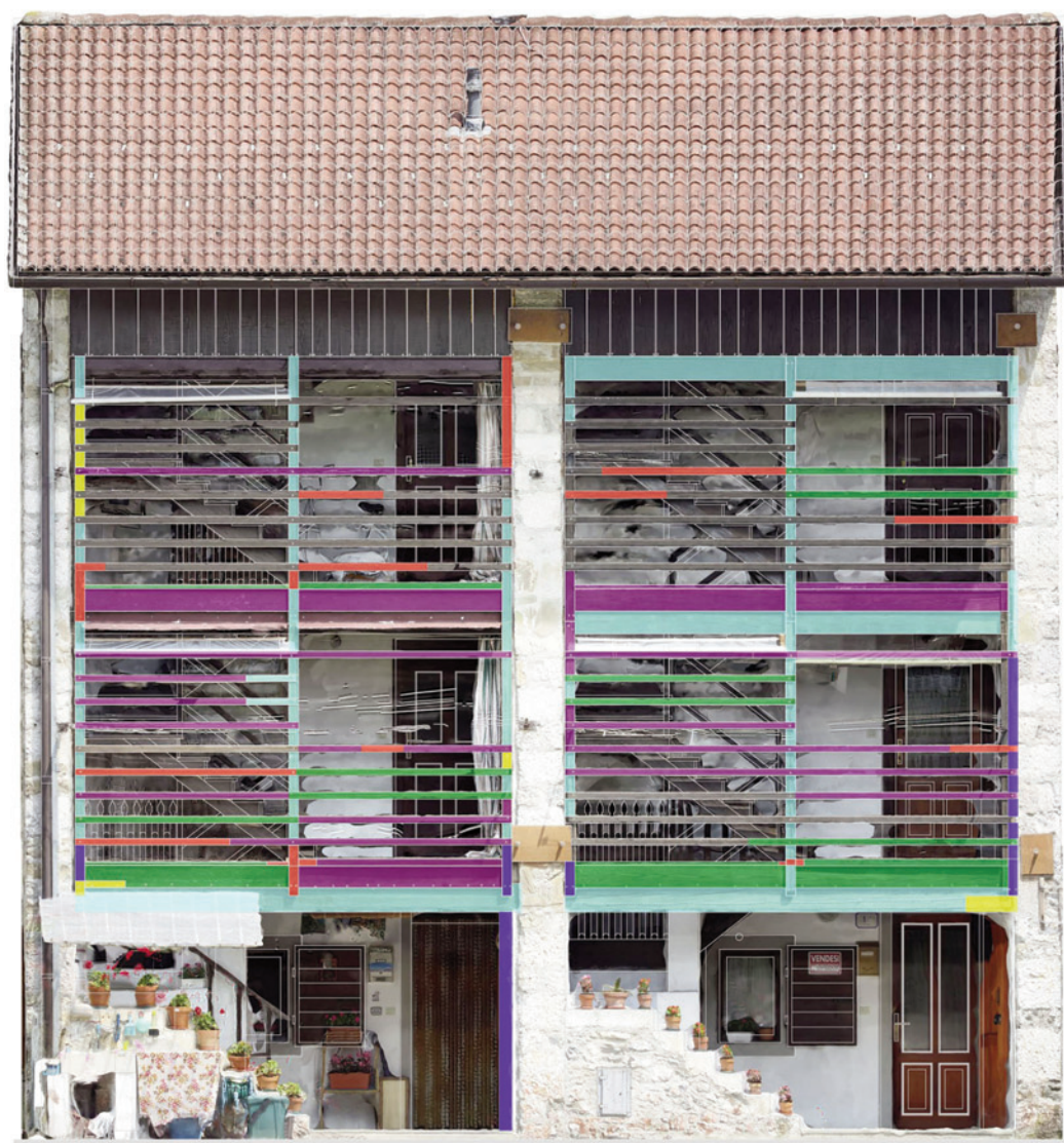
Fig. 8 | Analysis of the degradation of the Daltz on Via dell'Acquedotto (credit: A. Biasi, 2024).
