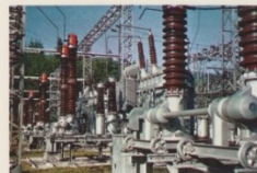
Allein die Lokomotiven der SBB benötigen im Jahr über 1 1/2 Milliarden Kilowattstunden elektrischer Energie. Sie wird ihnen aus den bahnigenen und anderen Kraftwerken über ein Netz von Übertragungsleitungen und durch Vermittlung der Unterwerke zugeführt. SBB-Unterwerk Rapperswil
