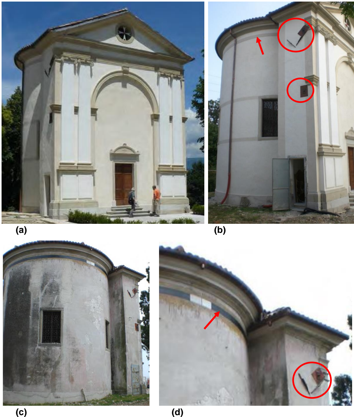
Fig. 5.21. Oratorio di Villa Lippomano a Monticella (TV) - Moussalli (2014): (a) fronte sud ; (b) particolare ingresso lato ovest ; (c)-(d) corpo dell'edificio costituito dall'unione di un volume cilindrico a nord (a sinistra) ed uno prismatico a sud (a destra). In rosso si evidenziano le piastre di ancoraggio delle catene metalliche applicate in direzione est-ovest e la cintura metallica al livello di imposta della copertura conoidale.
