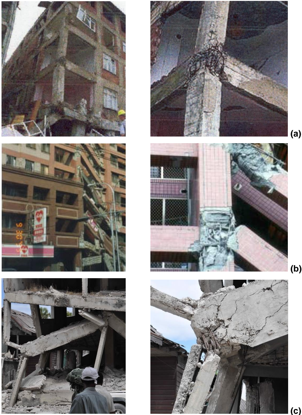
Fig. 1.1. Collasso di edifici con rottura dei nodi trave-pilastro: (a) Izmit (Turchia) - 17 agosto 1999 (Sezen et al., 2000); (b) Chi-Chi (Taiwan) - 21 settembre 1999 (Uang et al., 1999); (c) Leogane (Haiti) - 12 gennaio 2010 (autore: Eduardo Fierro ).
