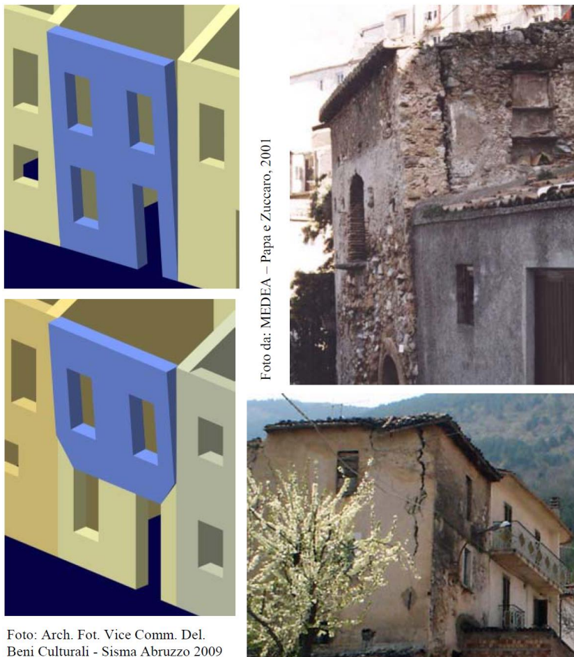
Fig. 5.4. Ribaltamento semplice di parete (Milano et al., 2011).
