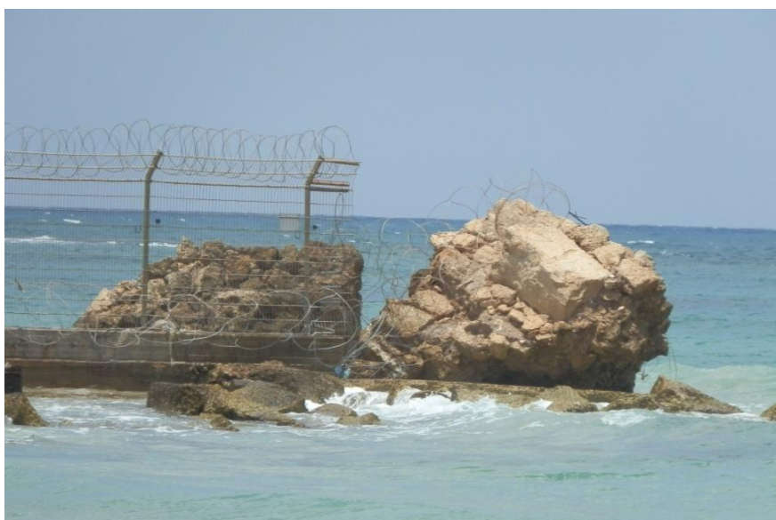
Fig.16: Danni alla torre nord, 2012.
