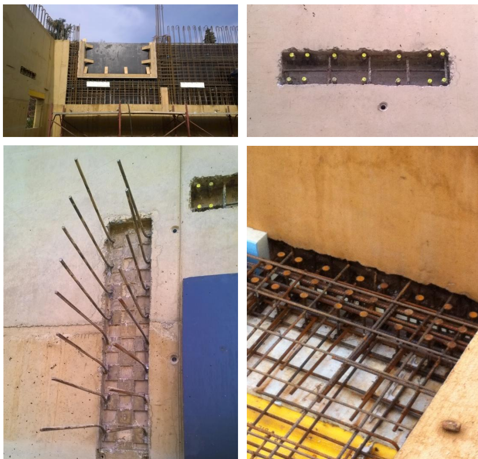
Figura 3.34 Particolari costruttivi in fase di cantiere. In alto a sinistra : armatura delle pareti perimetrali del 1P/2P. Si possono notare gli elementi a perdere utilizzati per la realizzazione delle nicchie di appoggio della soletta ed un elemento di ripresa per il trasferimento del taglio alla parete interna ortogonale. In alto a destra : nicchia di appoggio con relativa armatura di ripresa manicottata. In basso a destra : particolare d'appoggio della soletta nella nicchia. Si possono notare gli spinotti di armatura a taglio, la partenza dell'isolamento perimetrale che realizza il giunto termico tra le pareti perimetrali e la soletta, l'isolante presente sull'intradosso della soletta posizionato in corrispondenza di ogni nicchia per allungare il percorso del flusso termico. In basso a sinistra : elemento tassellato di ripresa del taglio presente lungo le interfacce B e C (Figura 3.35). Lungo l'interfaccia A è stata invece realizzata un'importante dentellatura in grado di garantire un collegamento monolitico.
