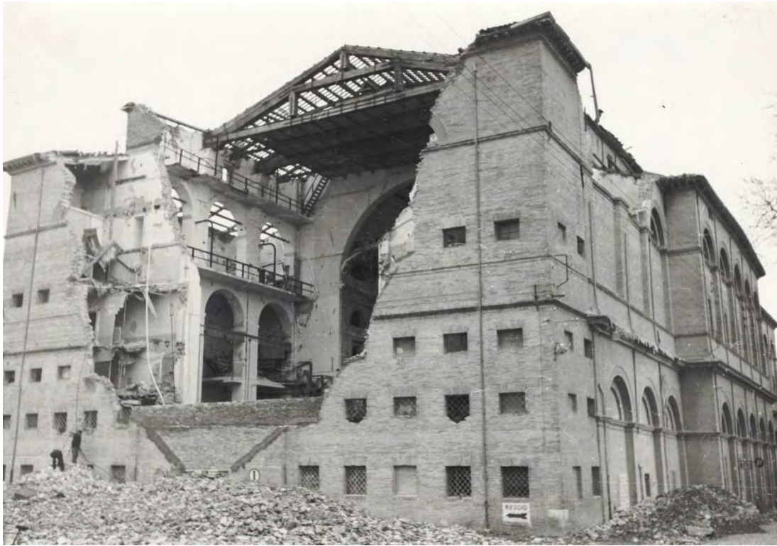
Figura 24: Foto del 1944 con i danni del bombardamento ed il muro costruito per proteggerlo dai saccheggi. (Foto B.G.R.)
