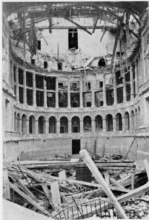
Figura 46: Foto del 1944 dove sono visibili gli ingenti danni causati dal bombardamento all’interno della sala. (Foto Minghini, archivio fotografico B.G.R.)
