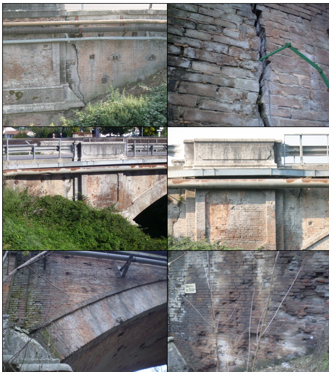
Fig. 4.11. Principali punti di danneggiamento
