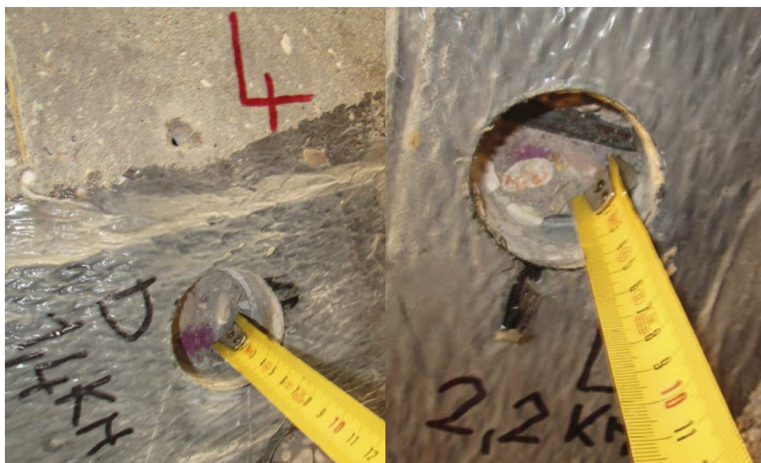
Fig. 3.20. Riscontro di calcestruzzo alcalino
