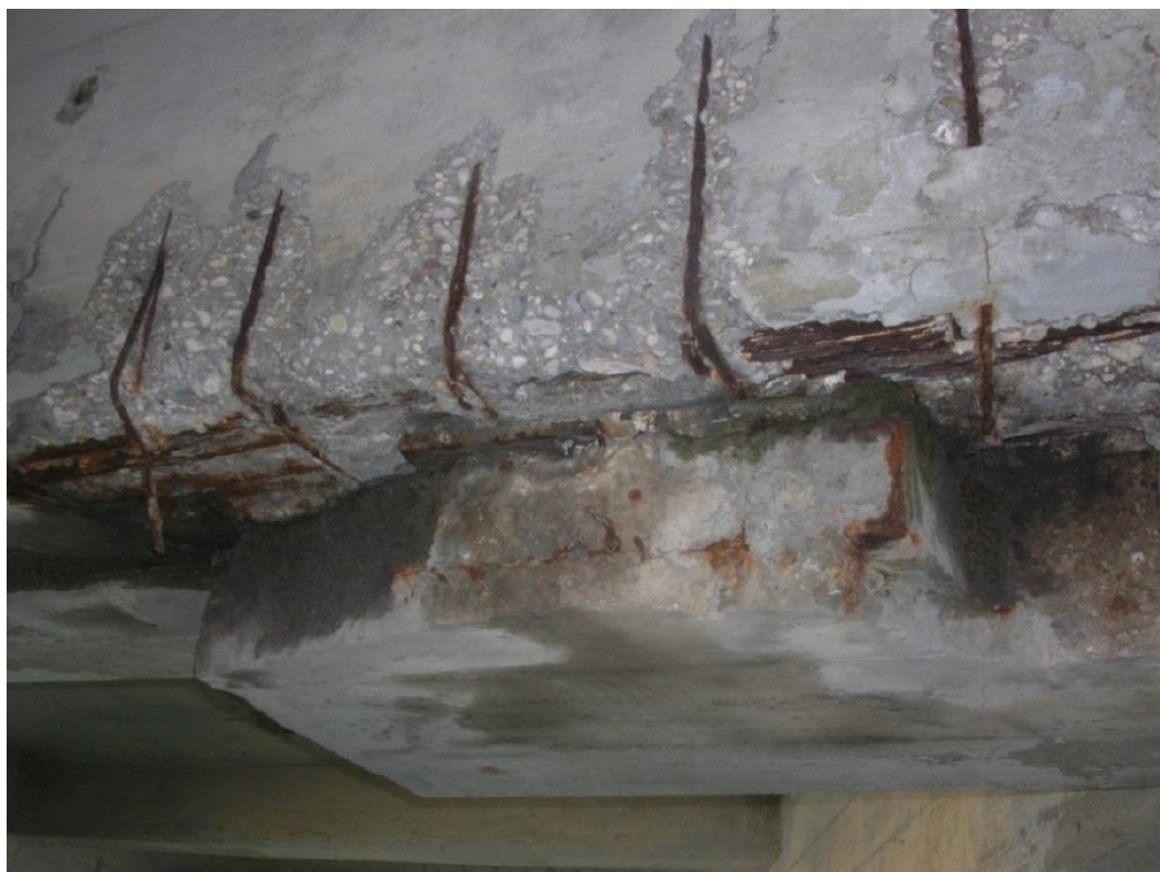
Fig. 3.6. Ammaloramenti delle selle del ponte sul vecchio canal salso
