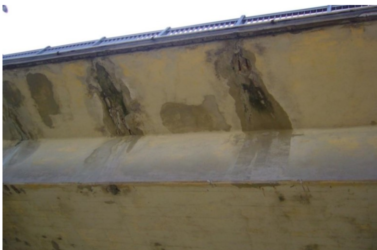
Fig. 3.9. Ammaloramenti della soletta superiore sugli impalcati del viadotto
