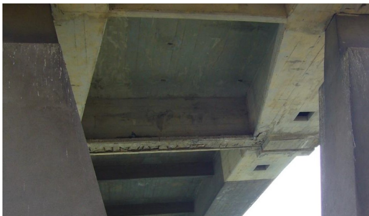
Fig. 3.7. Ammaloramenti delle selle del ponte sul nuovo canal salso
