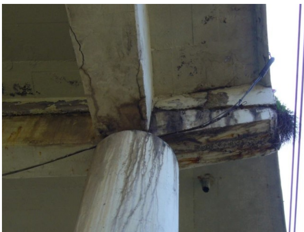
Fig. 3.8. Ammaloramenti delle selle della parte di viadotto connesso alla S.R. 11
