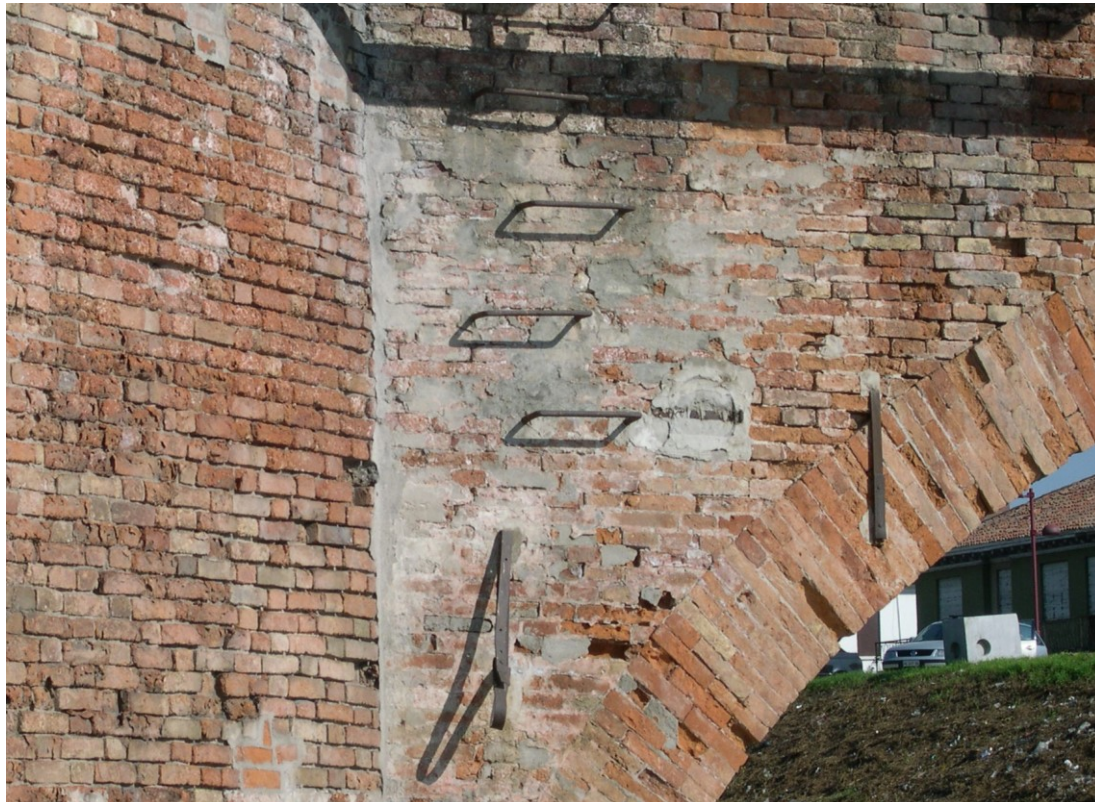
Fig. 5.10. Foto danneggiamento rilevato nel ponte
