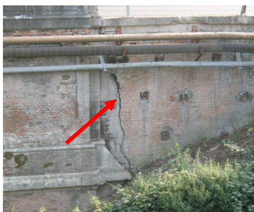
Fig. 4.10. Fessura nel muro nord della spalla ovest
