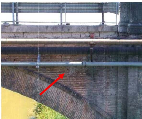
Fig. 4.9. Fessura nel muro di contenimento nord verso la spalla ovest
