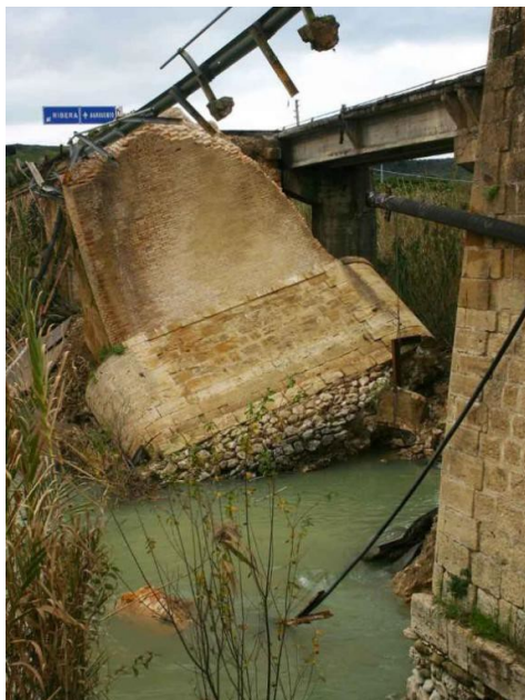
Fig. 4.1. Il collasso del “Ponte Verdura” a Sciacca (AG)
