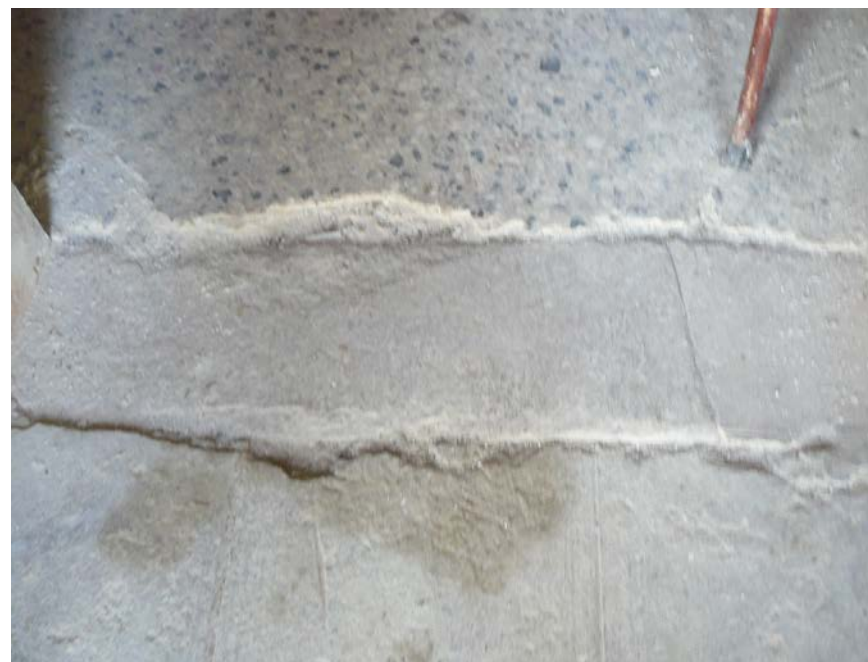
Fig. 5.32 Pavimentazione danneggiata dalle continue infiltrazioni di acqua.
