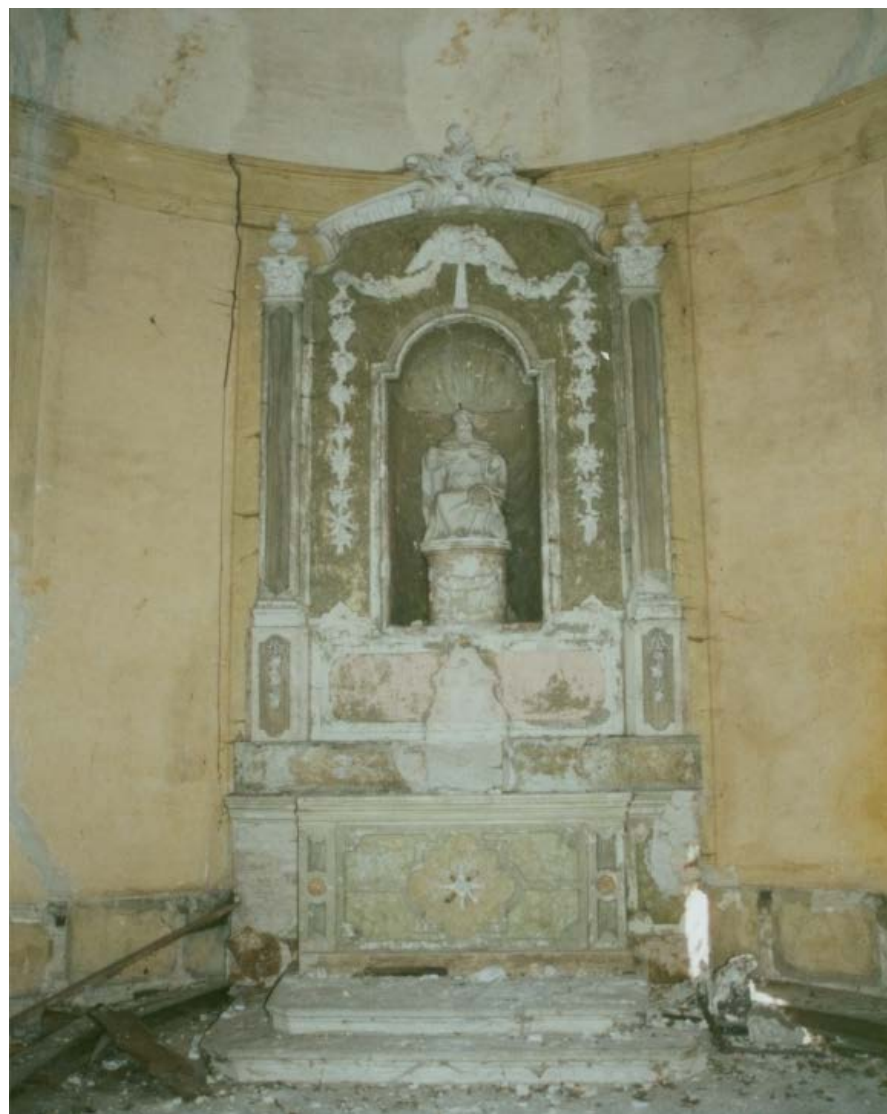
Fig. 5.50 Altare danneggiato dagli atti di vandalismo, vista dell'insieme.
