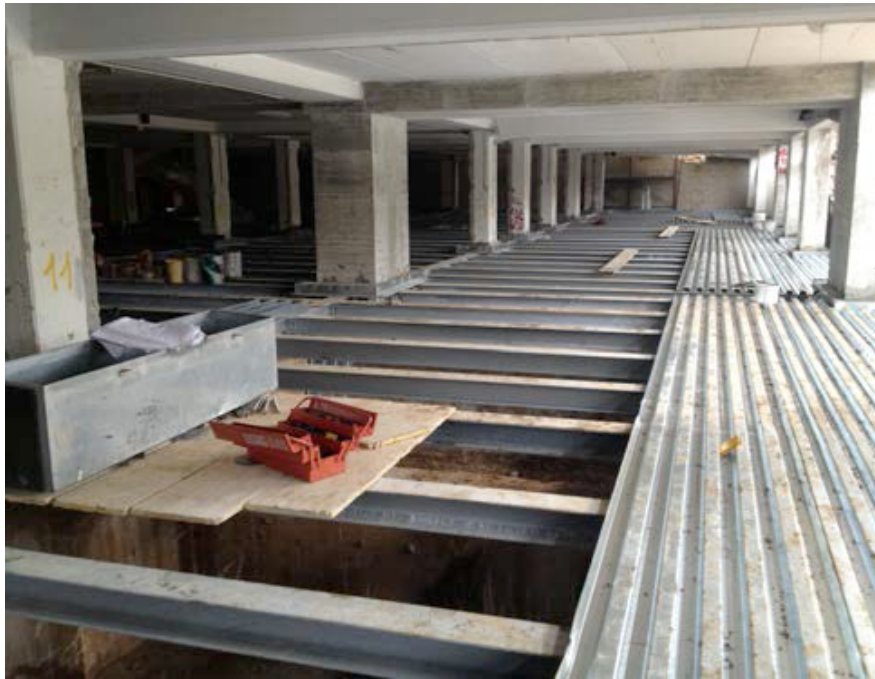
Fig. 6. 24 - Foto di cantiere riferibile alla posa delle travi in acciaio e delle lamiera grecate per la formazione del nuovo impalcato
