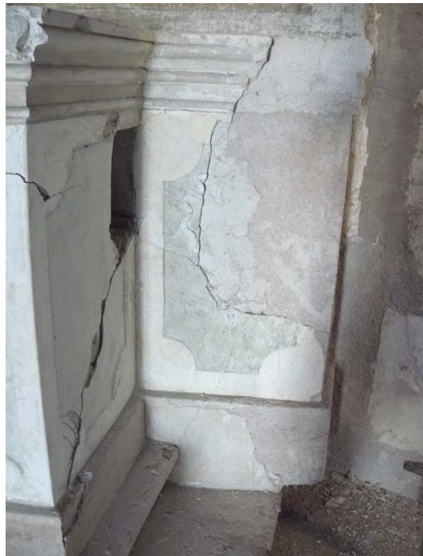
Fig. 5.52 Altare durante in restauro dell'apparato decorativo, dettaglio della decorazione in marmorino danneggiata dagli atti vandalici.
