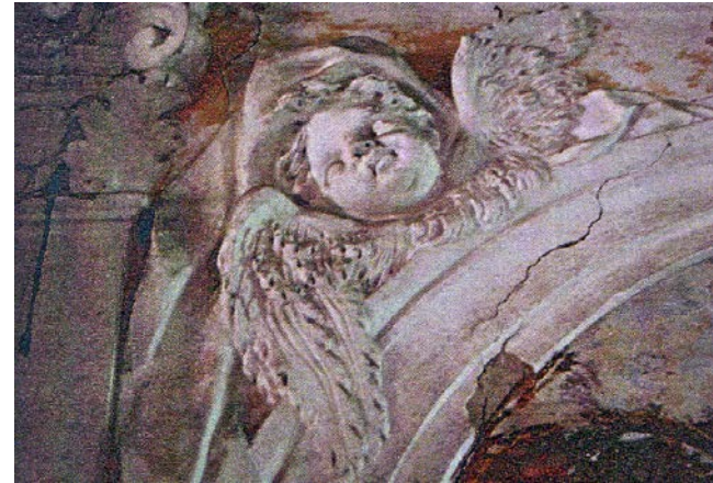
Fig. 5.39 Fessurazione. Dovuta principalmente a dissesti statici o deformazioni dei materiali.
