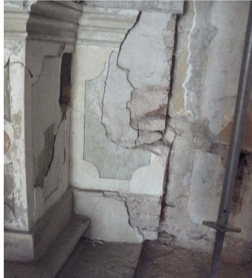
Fig. 5.57 Cappella gentilizia. Particolare delle specchiature in marmorino. Prima del restauro.
