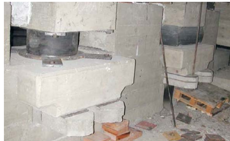
Fig. 2.28 – Dettaglio del nuovo isolatore e quello ancora da sostituire, scuola elementare Enrico Pestalozzi, 2006, Skopje, Macedonia, archivio prof. James M. Kelly.
