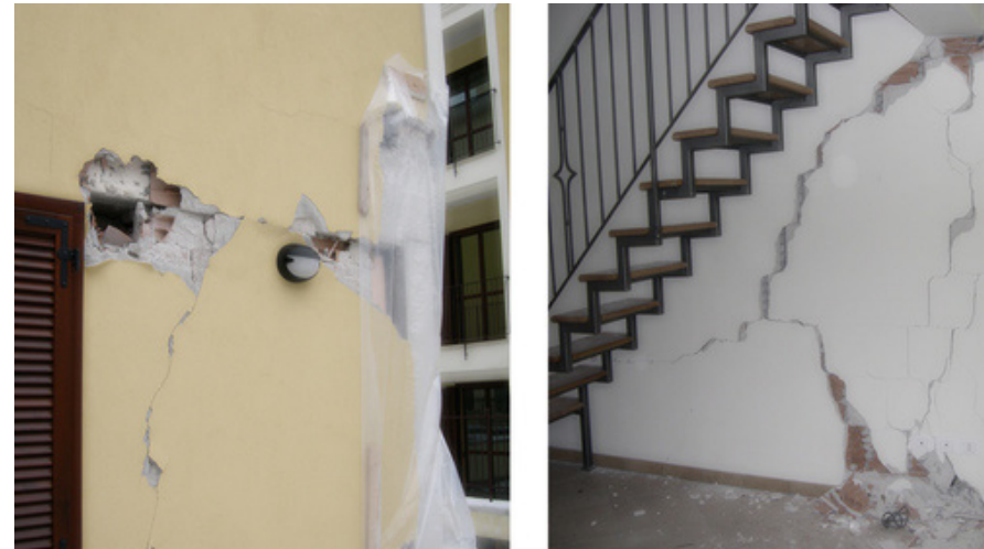
Fig. 6.10 – Danni riportati dall'immobile colpito dall'avvenimento tellurico
