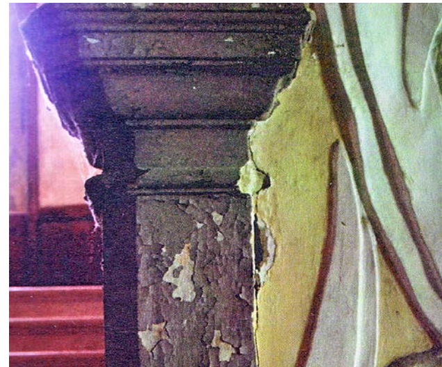
Fig. 5.40 Esfoliazione. Il Fenomeno interessa in maniera pressoché generalizzata buona parte degli intonaci.
