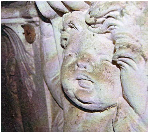
Fig. 5.34 Alveolizzazione. Quasi tutte le superfici degli stucchi risultano degradate. L'erosione interessa indistintamente sia stucchi cheintonaci manifestandosi anche sottoforma di distacco di scaglie di materiale.
