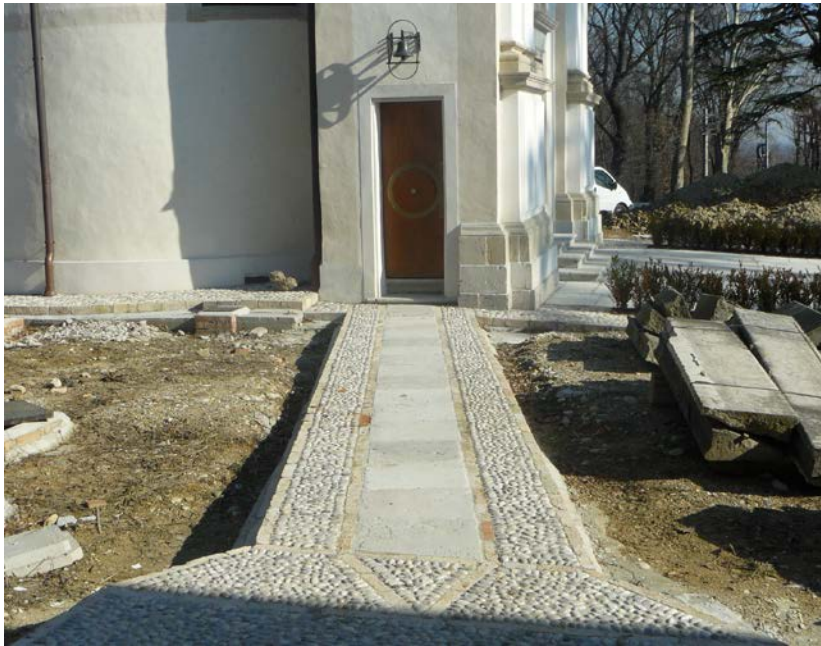
Fig. 5.70 - Vista della pavimentazione di collegamento, tra la villa e la cappella, realizzata e trattata con prodotti idro-repellenti.
