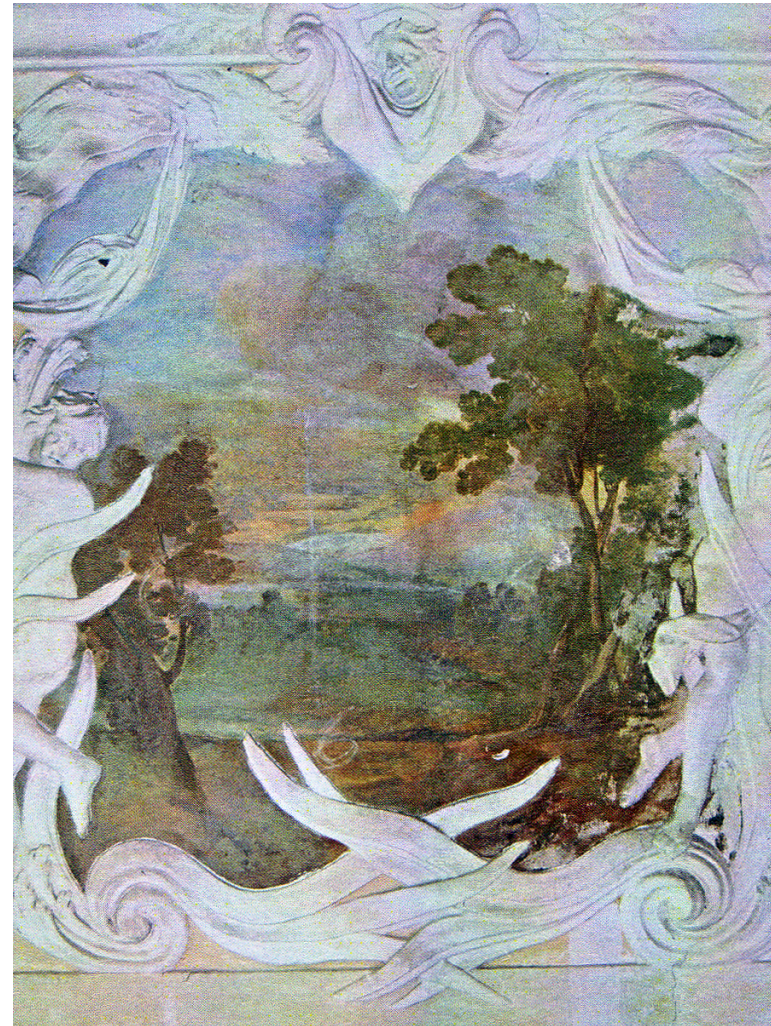
Fig. 5.33 Affresco interessato da depositi superficiali e patina, tale degrado è presente in maniera generalizzata su tutte le superfici delle decorazioni del corridoio.
