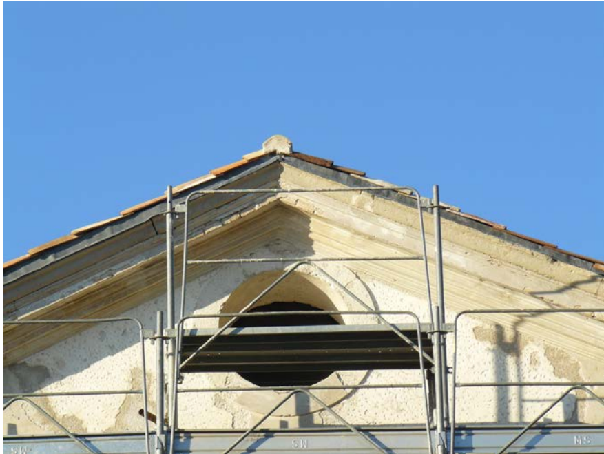
Fig. 5.46 Rimozione meccanica degli intonaci e degli rappezzamenti cementizi accertati come non originali.
