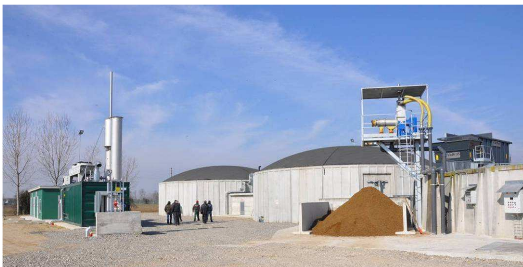
Figura 74: panoramica dei digestori e del gruppo di cogenerazione containerizzato.
