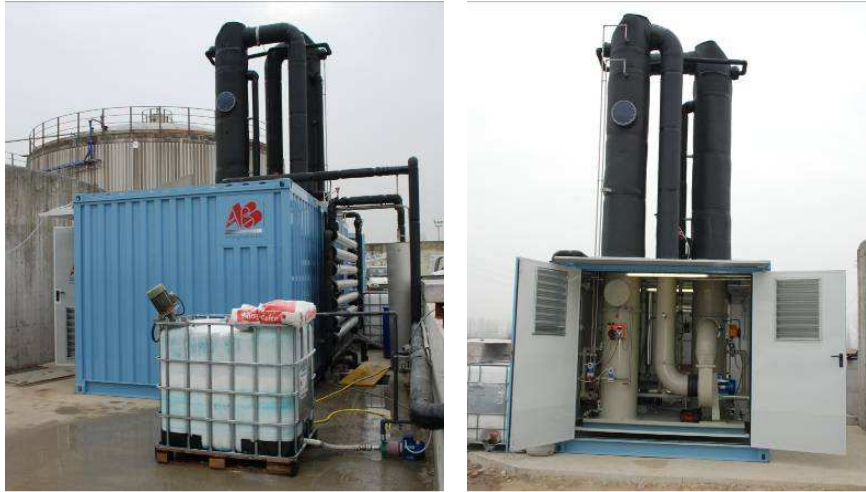
Figura 21: impianto di strippaggio dell'ammoniaca dal digestato (fonte: Chiumenti).
