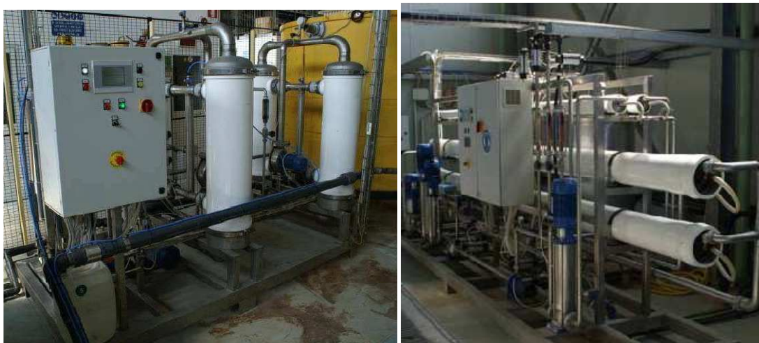
Figura 58: a sinistra l'impianto di ultrafiltrazione (quarta fase), a destra quello di osmosi inversa (quinta fase) (Foto:Chiumenti).
