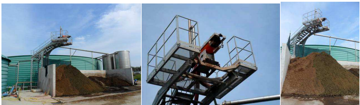
Figura 35: separatore a compressione elicoidale dell'impianto di Teglio Veneto (Foto A. Chiumenti).
