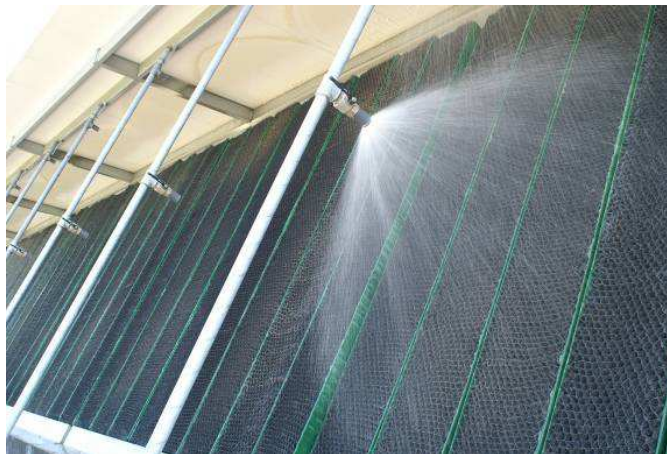
Figura 19: batteria di evaporazione posta a valle di un impianto biologico di nitro-denitro (fonte: Chiumenti)
