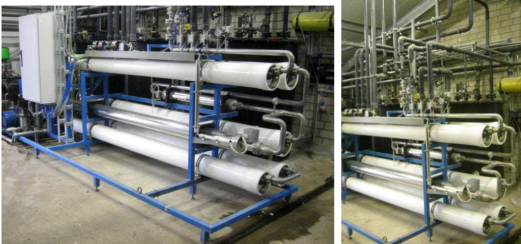
Figura 18: impianto di osmosi inversa (fonte: Envitec A3)
