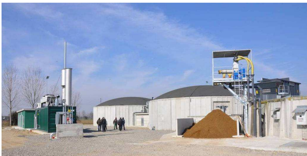
Figura 33: panoramica dei digestori, del gruppo di cogenerazione containerizzato e del separatore.
