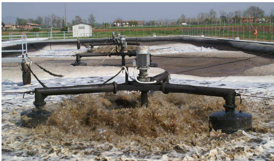
Figura 16: vasca di ossidazione di un impianto di nitrificazione-denitrificazione, con in evidenza le turbine di aerazione (foto: Chiumenti).
