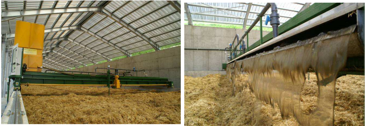
Figura 70: carroponete per la distribuzione dei liquami sul letto di paglia. Su tale attrezzatura è installato anche l'apparato di rivoltamento/aerazione a coclee utilizzato per aerare il materiale compostato (foto: Chiumenti)
