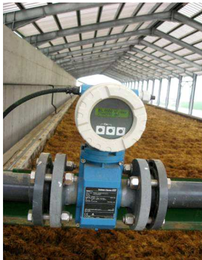
Figura 89: particolare del contatore dei liquami installato sul carroponete di distribuzione/rivoltamento.
