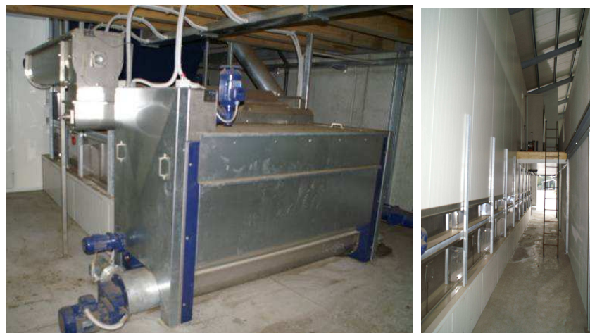
Figura 113: particolari della batteria di essiccazione (a sinistra) e della struttura di contenimento dell'aria esausta (a destra).
