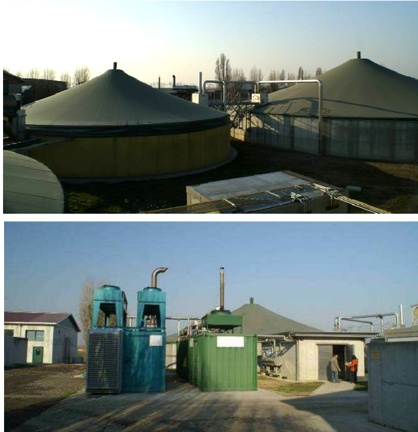
Figura 31: particolari dell'impianto di digestione anaerobica con in evidenza un fermentatore ed i gruppi di cogenerazione.
