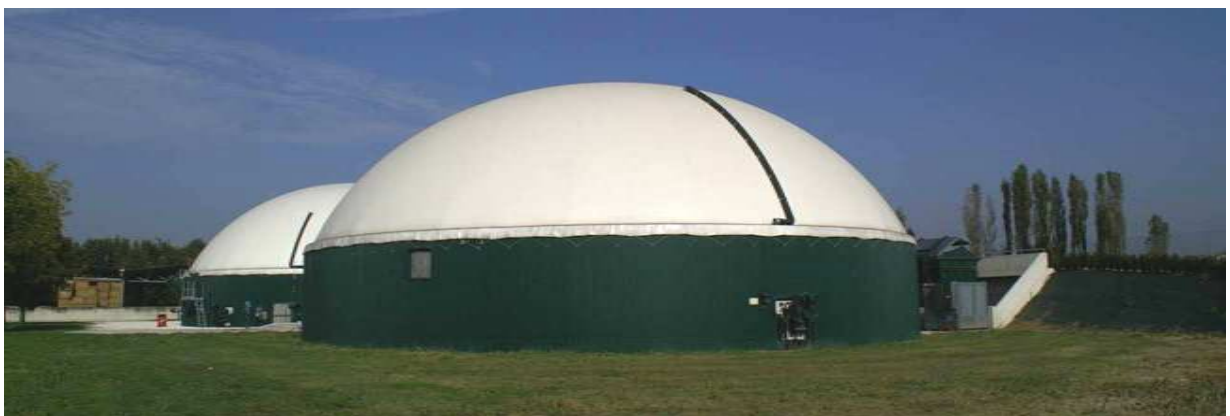
Figura 29: primo piano dell'impianto di biogas (Foto A. Chiumenti)..
