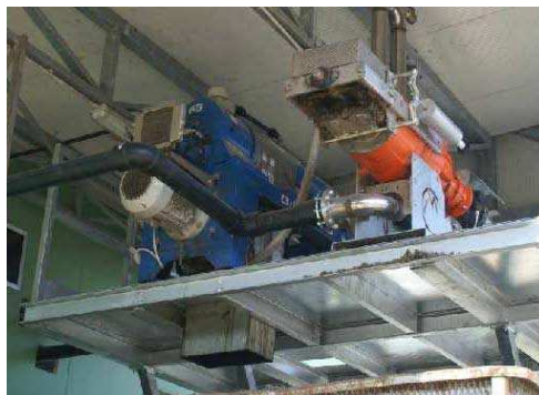
Figura 56: a destra il separatore a compressione elicoidale(prima fase), a sinistra la centrifuga (seconda fase) (Foto: Chiumenti)
