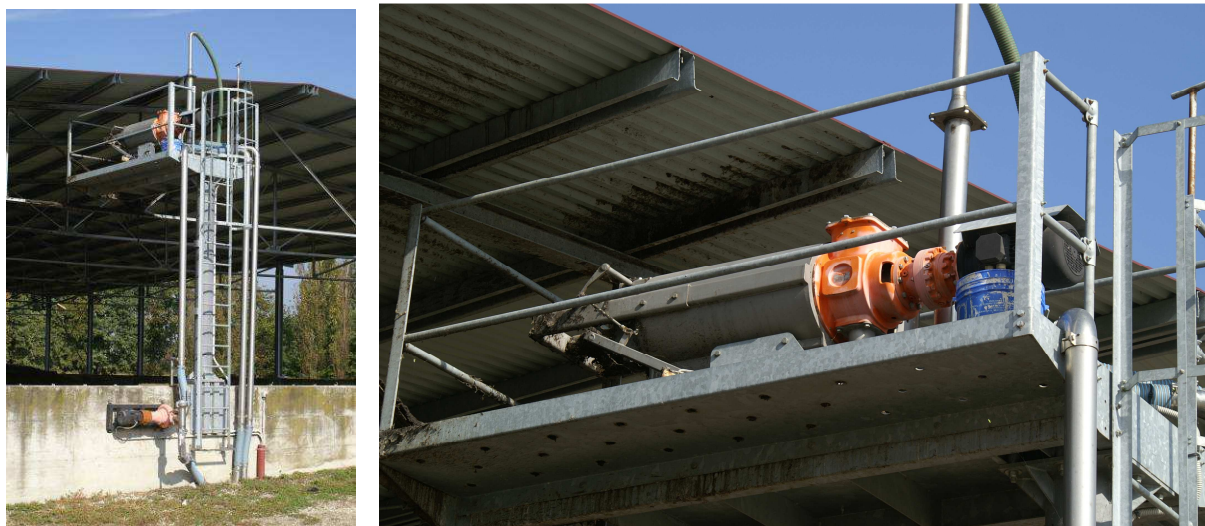
Figura 30: separatore a compressione elicoidale installato a Terrassa Padovana.
