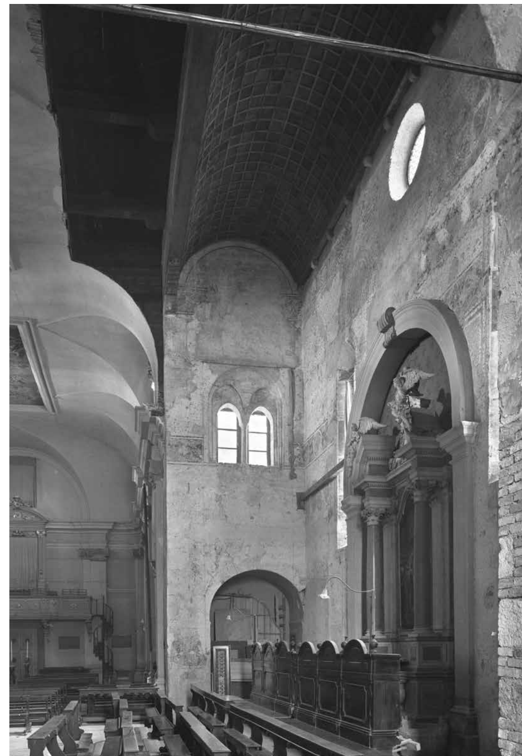
7. Braccio sinistro del transetto nel 1934, dopo l'intervento di F. Forlati. Il passaggio verso le cappelle laterali è chiuso; si noti in corrispondenza la nicchia, alla cui apertura in epoca imprecisata si deve la perdita di una vasta porzione di affreschi con Storie del Beato Odorico (parete est della cappella quattrocentesca).
